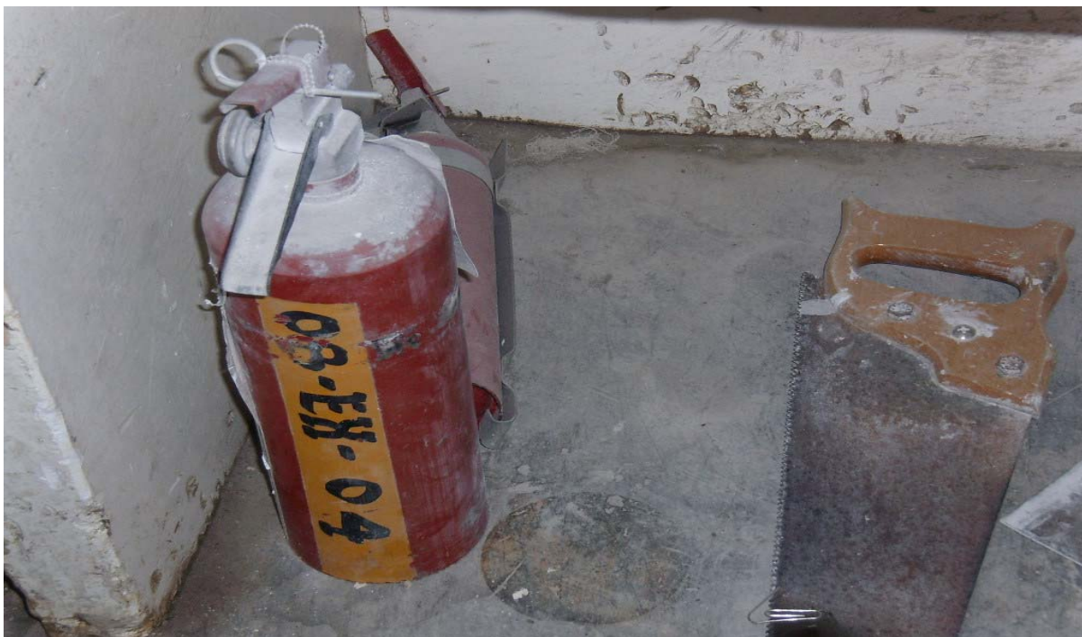
Figura 22. Equipo de Seguridad en el Suelo y sin Señalización.
