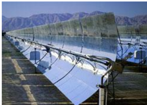
Figura 10. Concentradores parabólicos (Placas solares, 2012).
